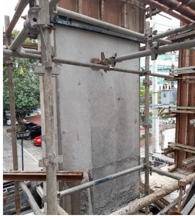
Gambar 4. Kondisi kolom yang mengalami bunting
